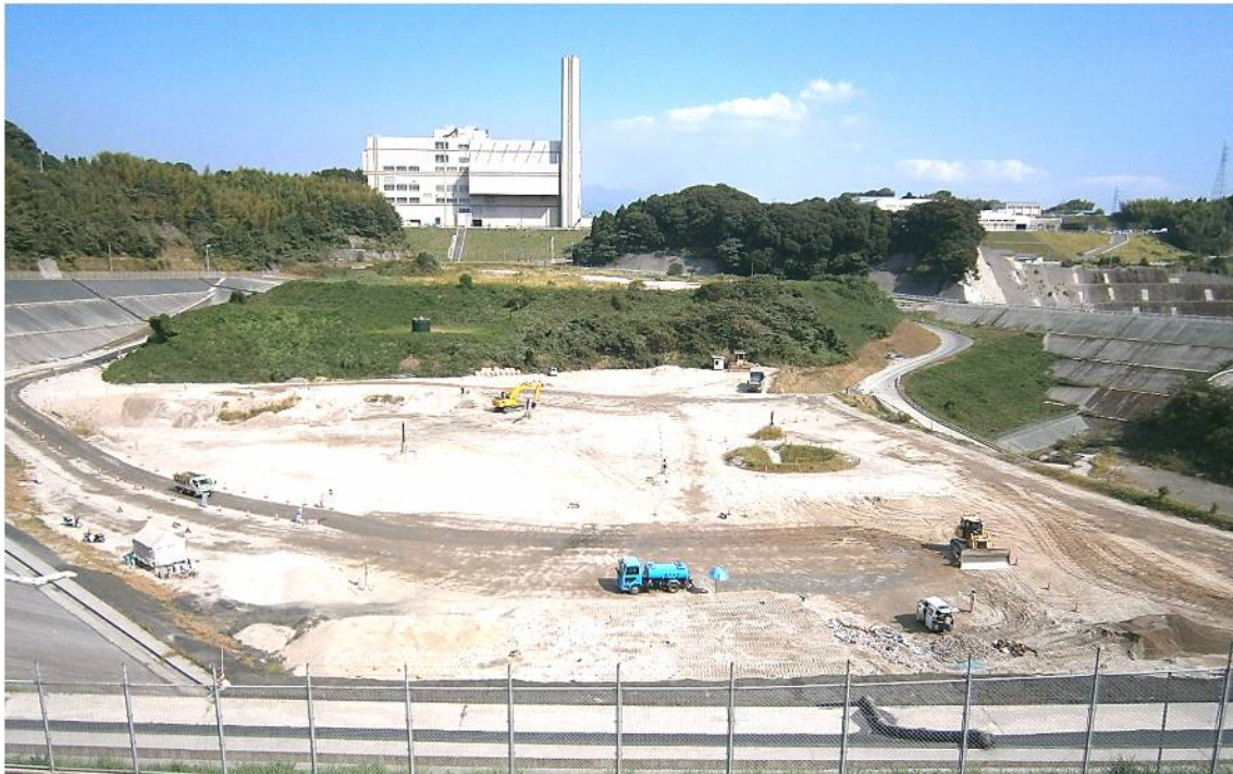
(施設の外観－ 2 工区)
